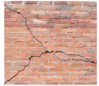
Daños en estructuras
